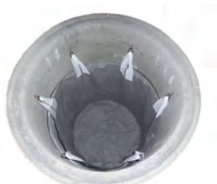
Eingebauter 1-lagiger Filtersack im Schacht DN 1000
